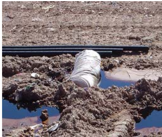
Figura 27 Tubería de captación de lixiviado
