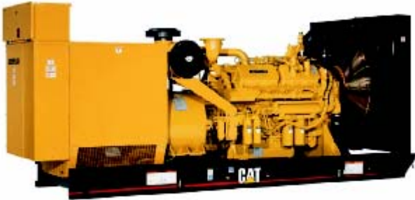
Figura 23. Fotografía del generador caterpillar 545 KW Prime
