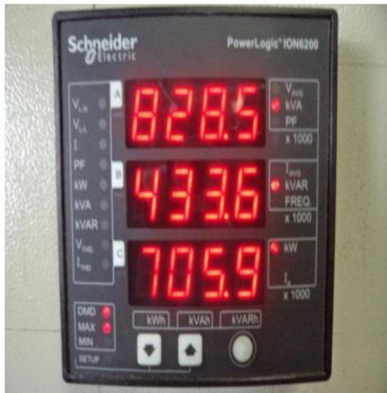
Figura 12. Medidor de energía Power Logic ION 6200
