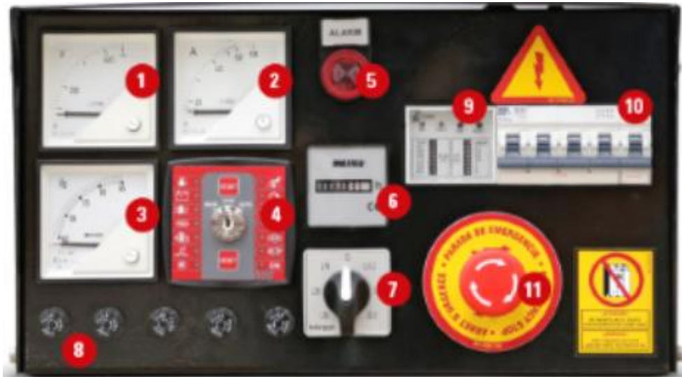
Figura 13. Cuadro de control manual M6
