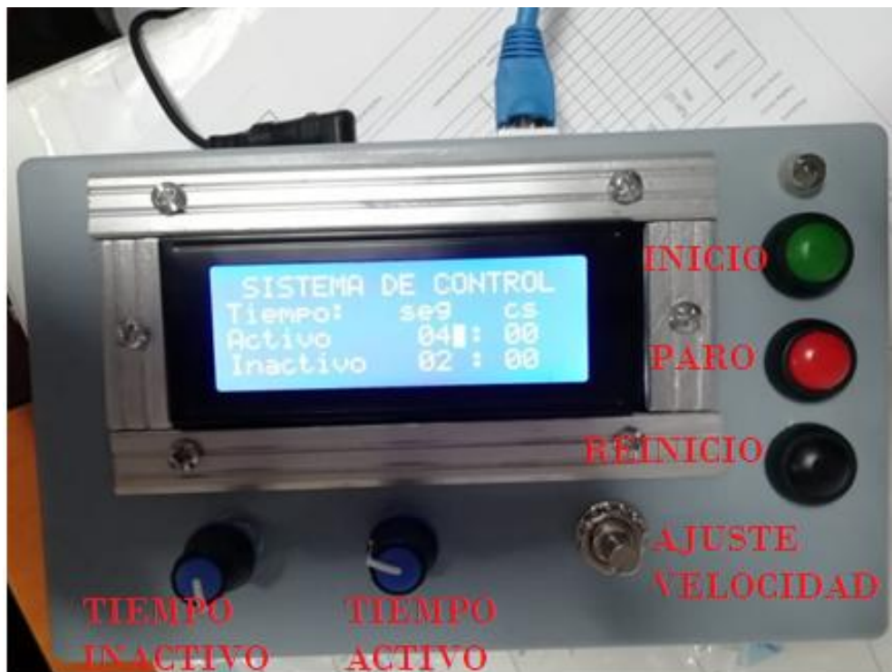
Figura 67. Mando de control de bomba peristáltico
