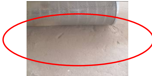
Figura 16. Foto filtro con demasiado polvo
