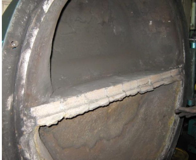
Figura 22. Puerta trasera de la caldera
