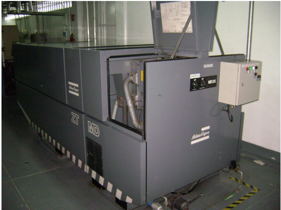
Figura 26. Compresor de aire de tornillo Atlas Copco ZT MD 25
