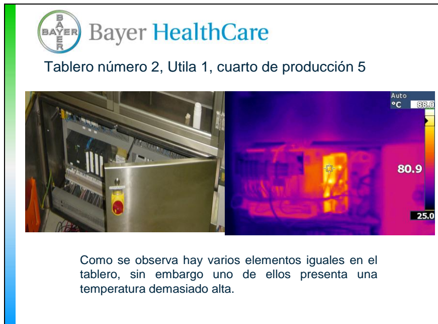
Figura 38. Ejemplo de reporte de termografía para tableros eléctricos y electrónicos
