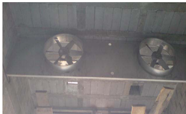
Figura 22. Equipo de ventilación forzada
