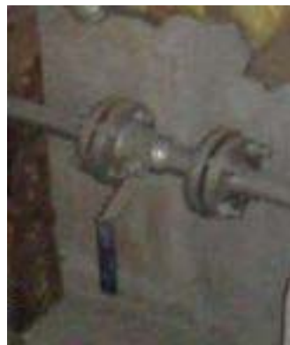
Figura 33. Válvulas manuales de vapor
