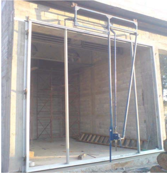
Figura 14. Ensamblaje del marco externo y del mecanismo de apertura y cierre de la compuerta
