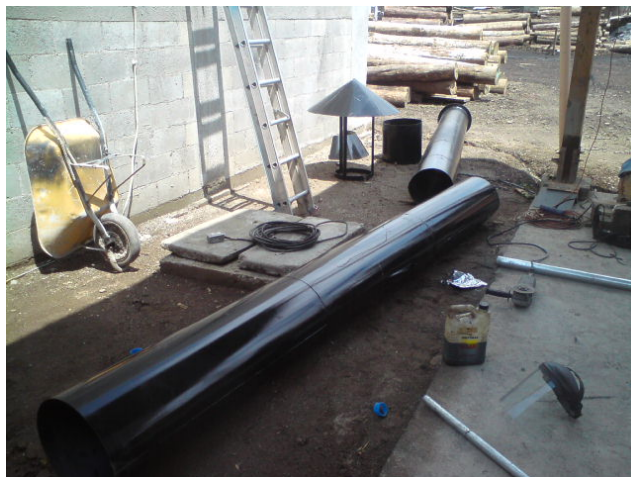
Figura 36. Tubos de chimenea
