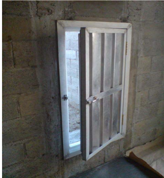
Figura 13. Puerta de inspección
