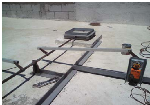
Figura 27. Actuador de apertura y cierre de paletas
