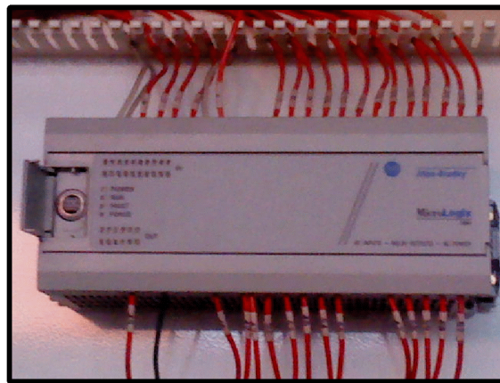
Figura 35. Microprocesador que controla los motores de la trituradora
