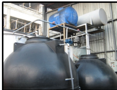
Figura 33. Planta de tratamiento
