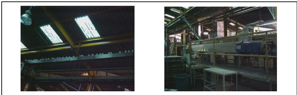
Figuran 17. Áreas de paletizado con deficiencia de luz
