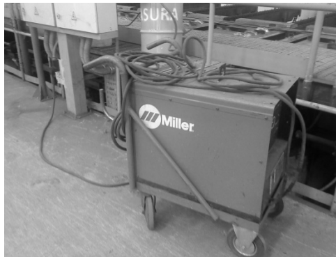
Figura 39. Identificación de peligro (eléctricos)
