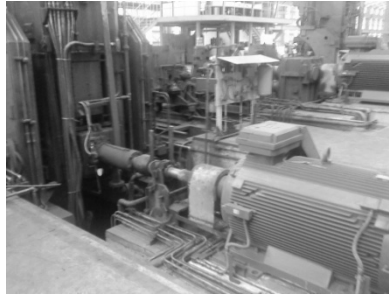
Figura 40. Identificación de peligro (mecánico)
