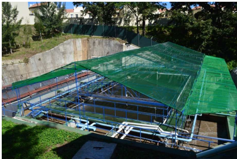
Figura 2. Vista general PTAR
