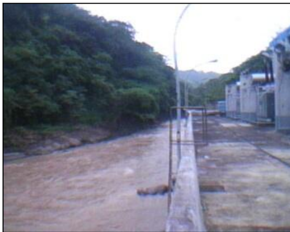
Figura 15. Patio de transformadores y Río María Linda
