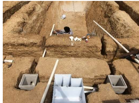
Instalación de cajas de distribución y entrada, instalación de tubería de interconexión.
