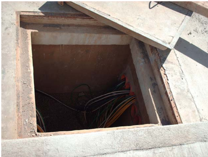
Figura 5. Cajas de registro para el cableado secundario.
