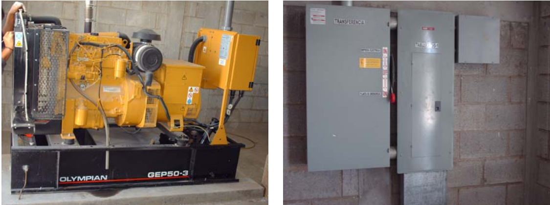
Figura 8. Planta de emergencia, transferencia y tablero TSG-1
