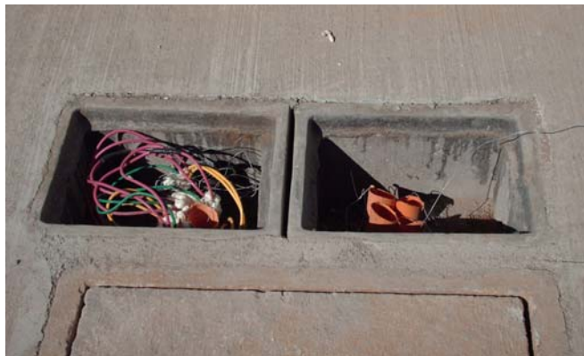
Figura 6. Cajas de registro para iluminación exterior
