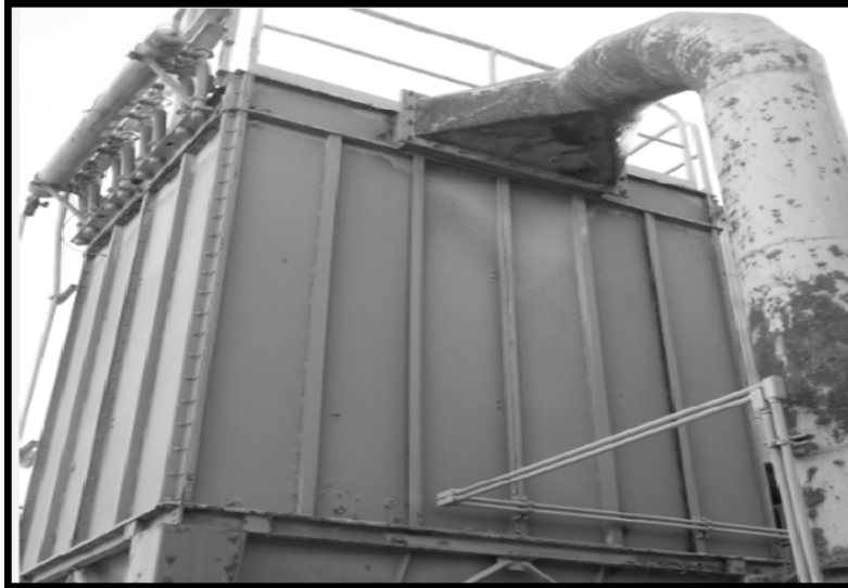
Figura 6. Filtro de despolve actual
