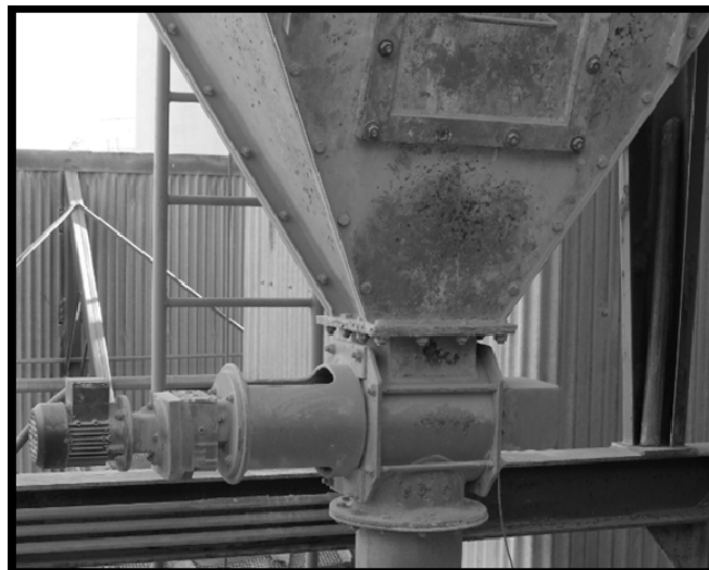
Figura 7. Válvula rotativa del filtro actual
