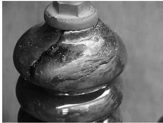
Figura 7 Aislador de tensión o amarre deteriorado
