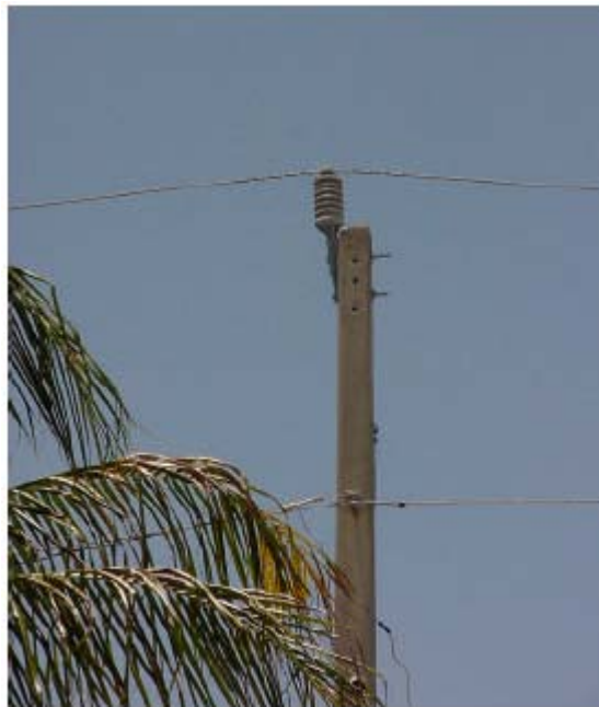
Figura 13. Líneas monofásicas de MT
