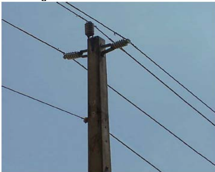
Figura 7. Líneas trifásicas de MT
