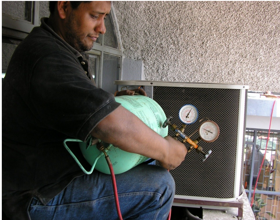
Figura 21. Recarga de refrigerante en el sistema
