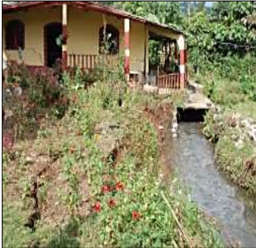
Figura 2. Esparcimiento lateral, después del terremoto del año 2012
