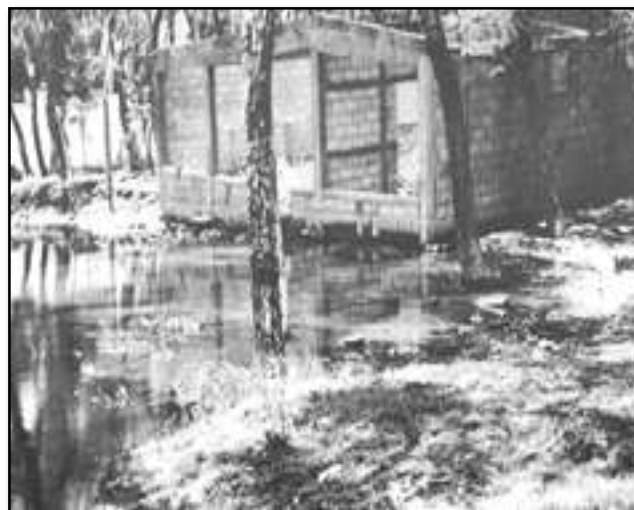
Figura 13. Colapso de pisos de concreto destruidos, comunidad El Sauzal, después del terremoto del año 1976, abril 1976
