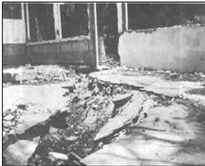
Figura 9. Grieta por propagación lateral de esfuerzos inducidos por sismos y desplazamiento verticales
