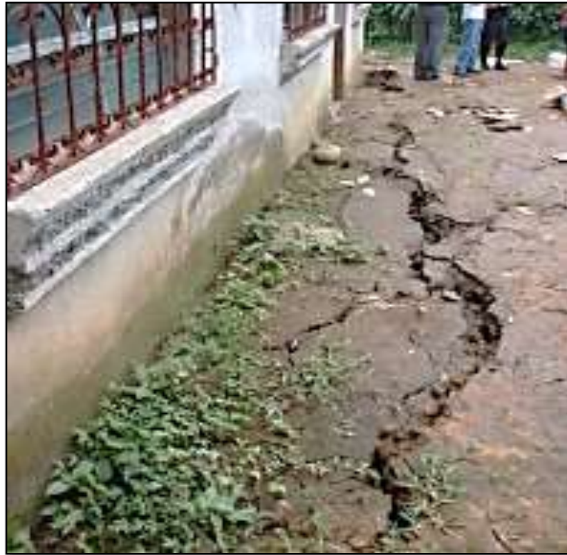
Figura 1. Asentamiento de vivienda, después del terremoto del año 2012
