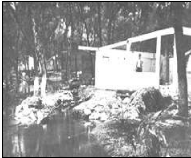
Figura 12. Colapso de vivienda, crestas por diferenciales laterales y verticales, consecuencia de la subsidencia del suelo
