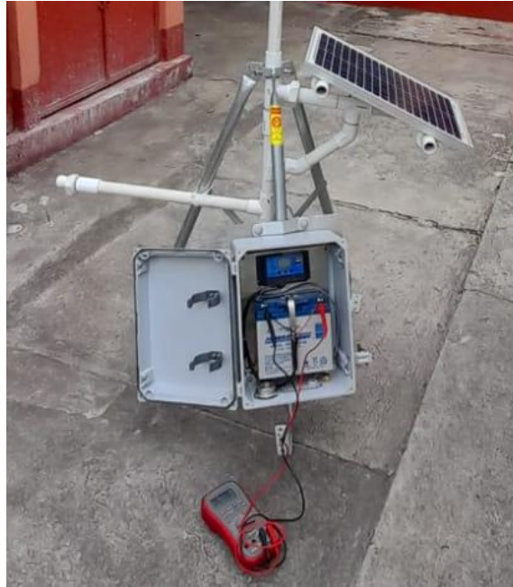
Figura 129. Implementación caja NEMA 4
