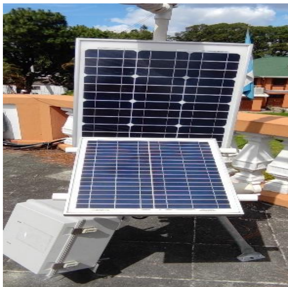
Figura 117. Incorporación panel solar
