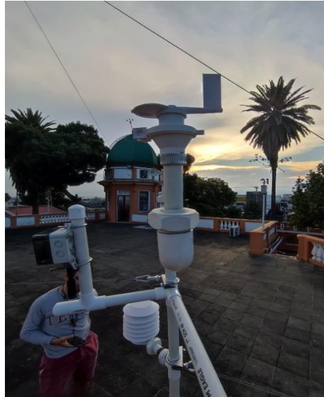
Figura 121. Instalación sensores meteorológicos
