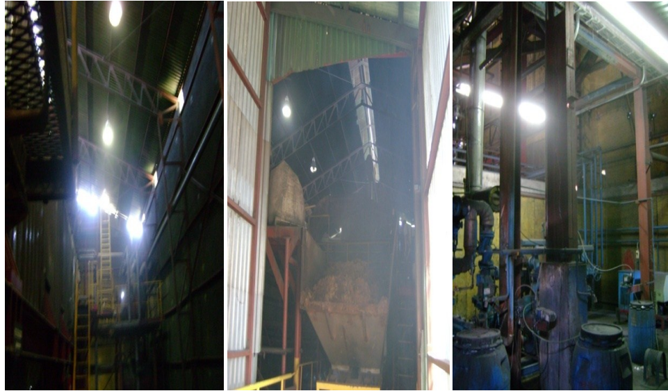
Figura 38. Cuarto de caldera Okuma y cuarto de bombas
