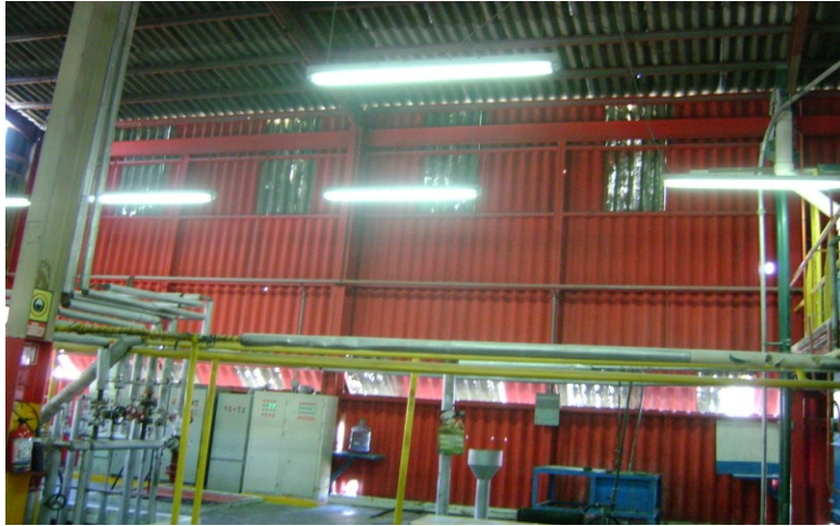
Figura 28. Láminas transparentes pintadas y en mal estado
