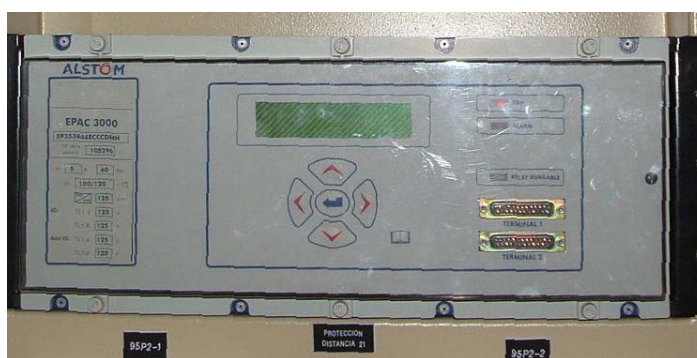
Figura 33. Montaje del EPAC 3000, en módulo 8DN9
