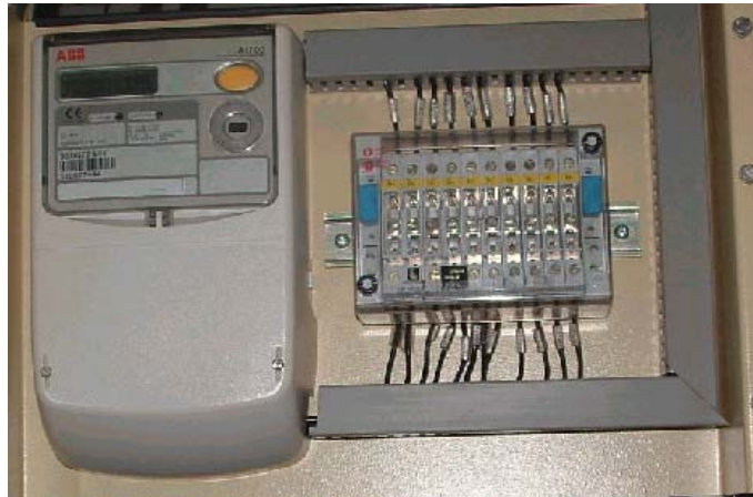
Figura 30. Medidor Polifásico Programable. ABB A 1700
