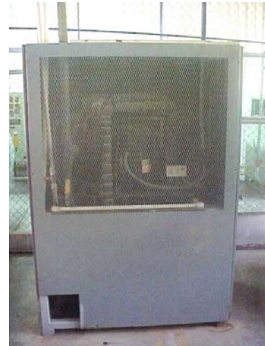
Figura 22. Chiller, lado frontal
