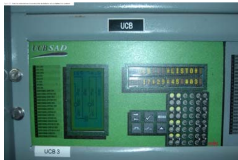
Figura 37 Control de bahía de subestación con mímico digital
