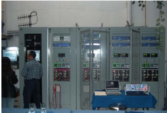
Figura 39 Tableros de control con equipos montados
