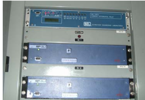
Figura 36 Relevadores de protección instalados en un tablero de control
