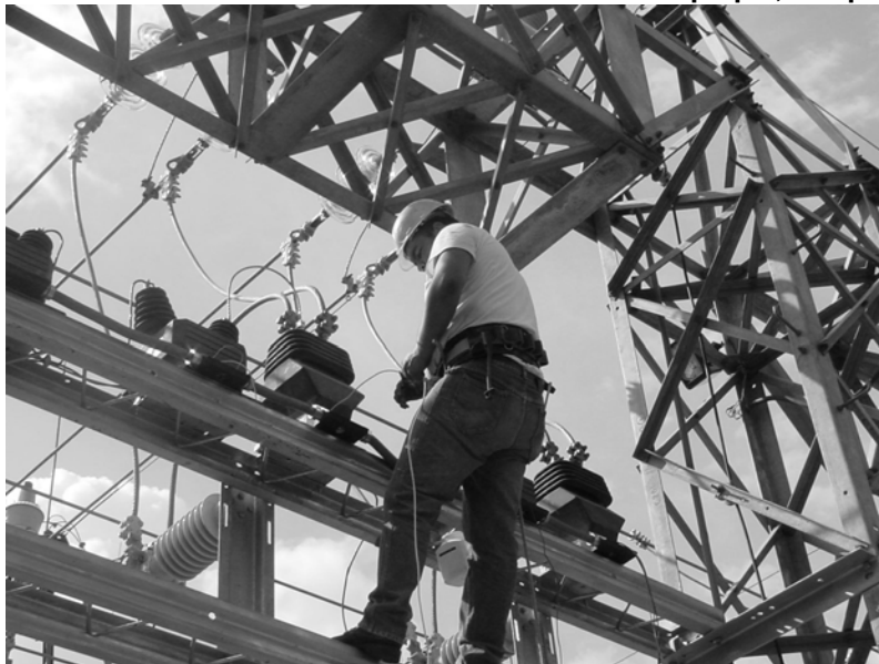
Figura 2. Personal técnico realizando la conexión del cableado secundario en medición 34.5 KV Subestación Quetzaltepeque, Chiquimula.
