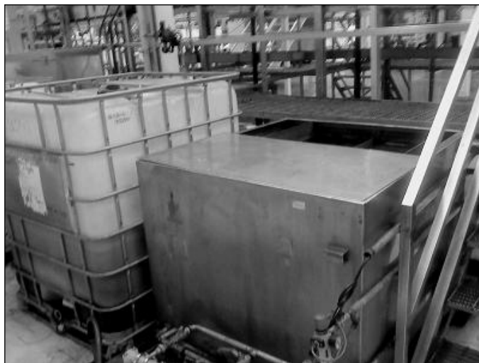
Figura A. Vista del tanque coalescente instalado
