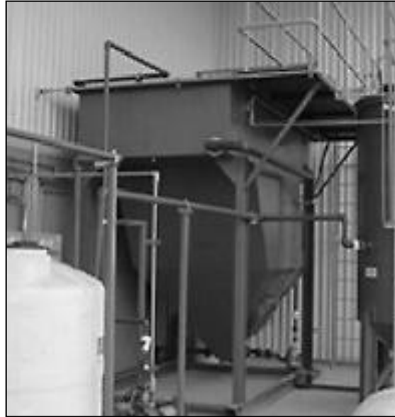
Figura 39. Tanque separador de lodos
