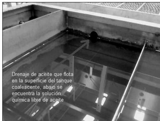
Figura B. Drenaje de aceite del tanque coalescente
