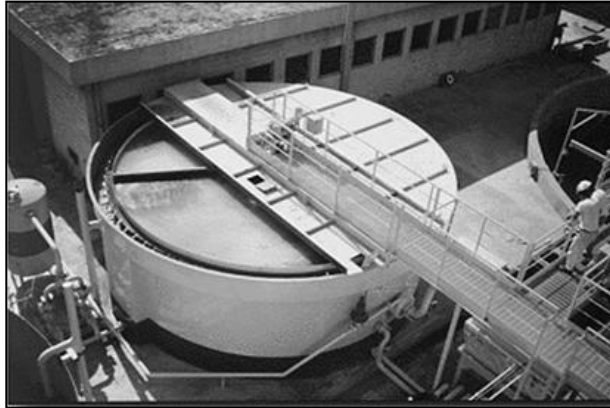
Figura 38. Tanque clarificador DAF
