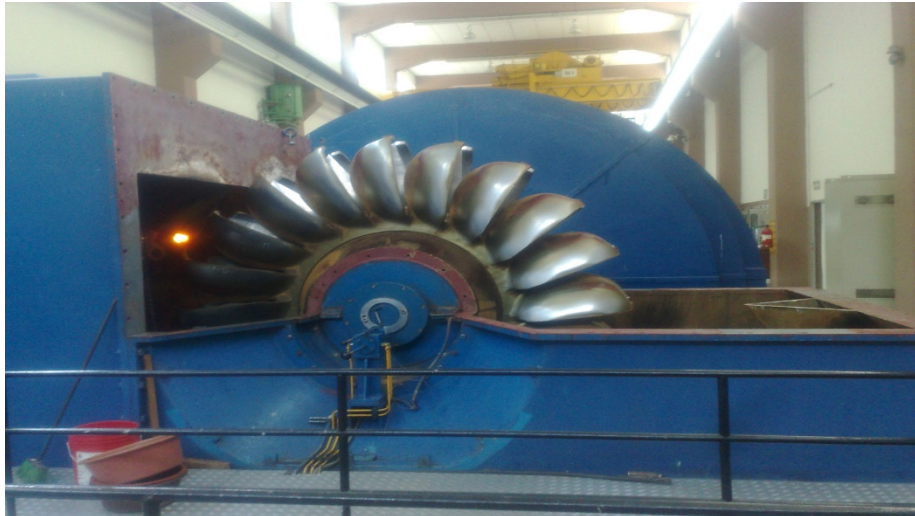
Figura 5. Rodete Pelton en operación de planta Aguacapa
