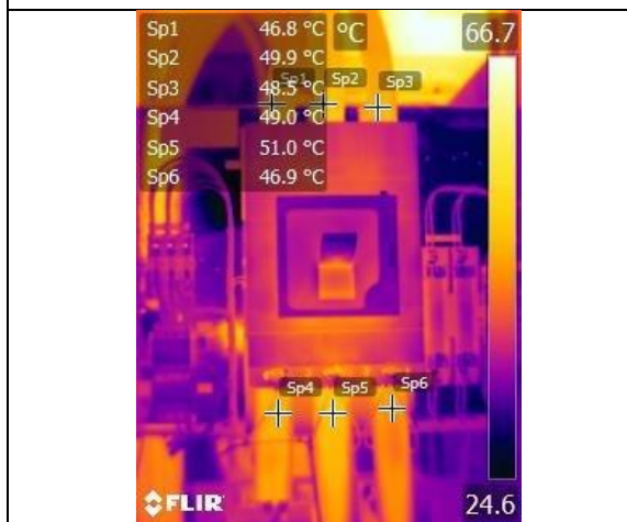
Imagen IR, interruptor principal
