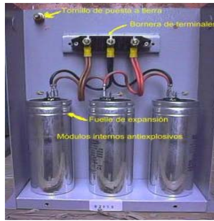
Figura 14. Capacitores conectados a un sistema eléctrico.
