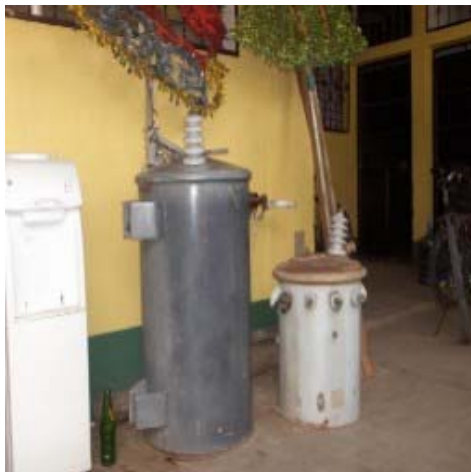
Figura 18. Transformadores en el corredor de una Municipalidad.
