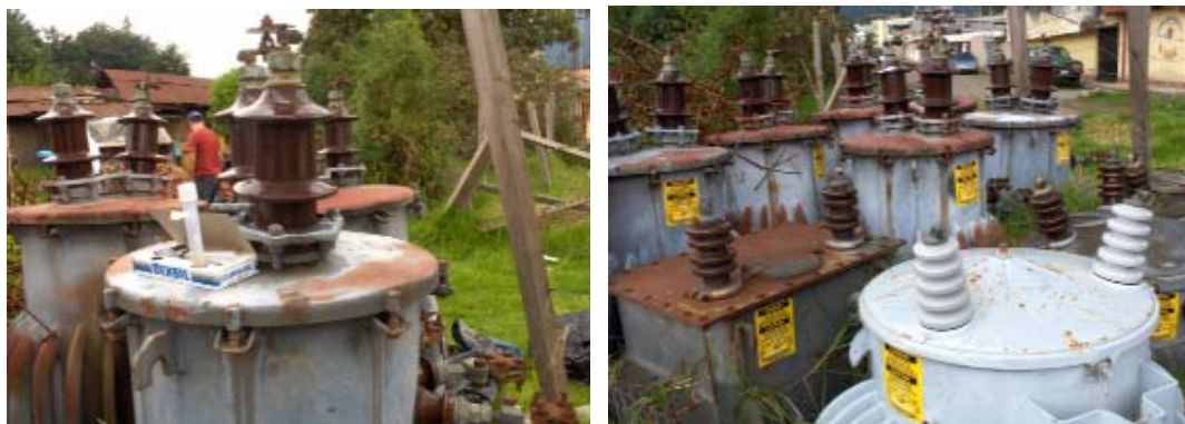
Figura 33. Transformadores con PCB en la Empresa Eléctrica de San Marcos.
