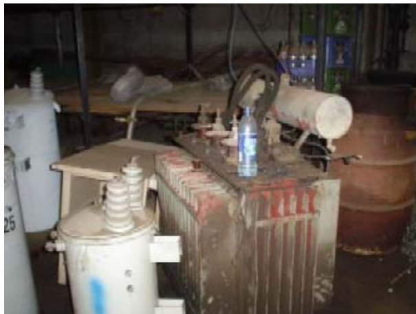
Figura 17. Bodega de una Empresa Eléctrica Municipal.
