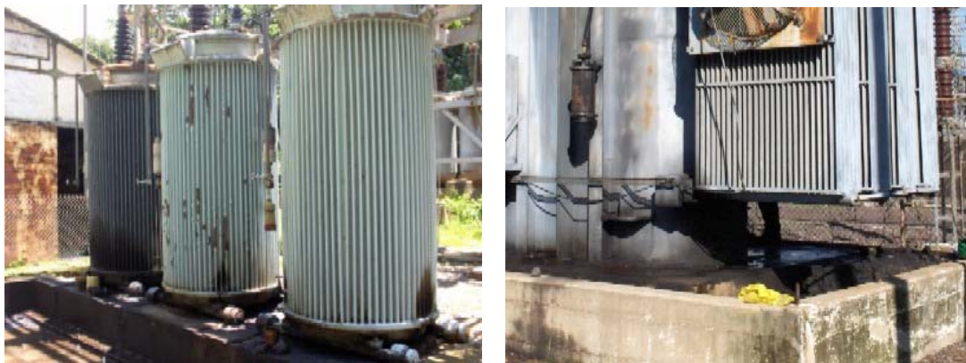
Figura 20. Transformadores con derrames.
