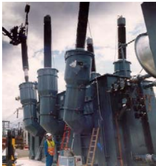
Fuente: ABB - Mantenimiento de Transformadores de Potencia.
