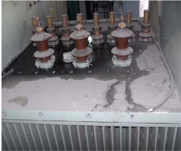
Fig. 16. Transformador con fugas.
