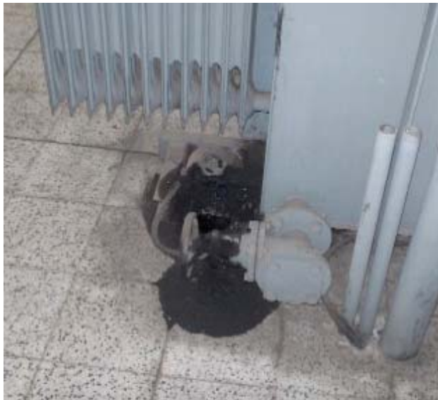
Figura 15. Transformador con derrames en la válvula de muestreo.
