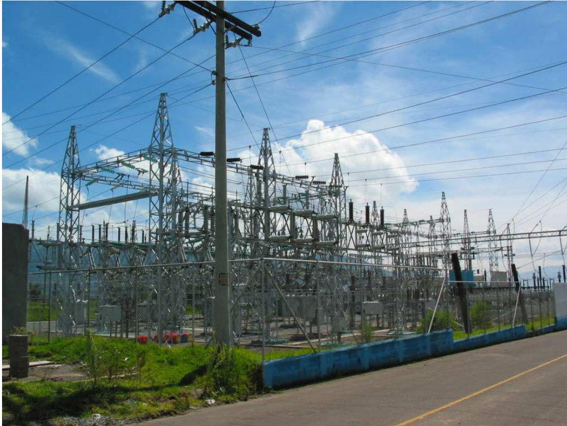
Figura 1. Subestación de La Esperanza.
