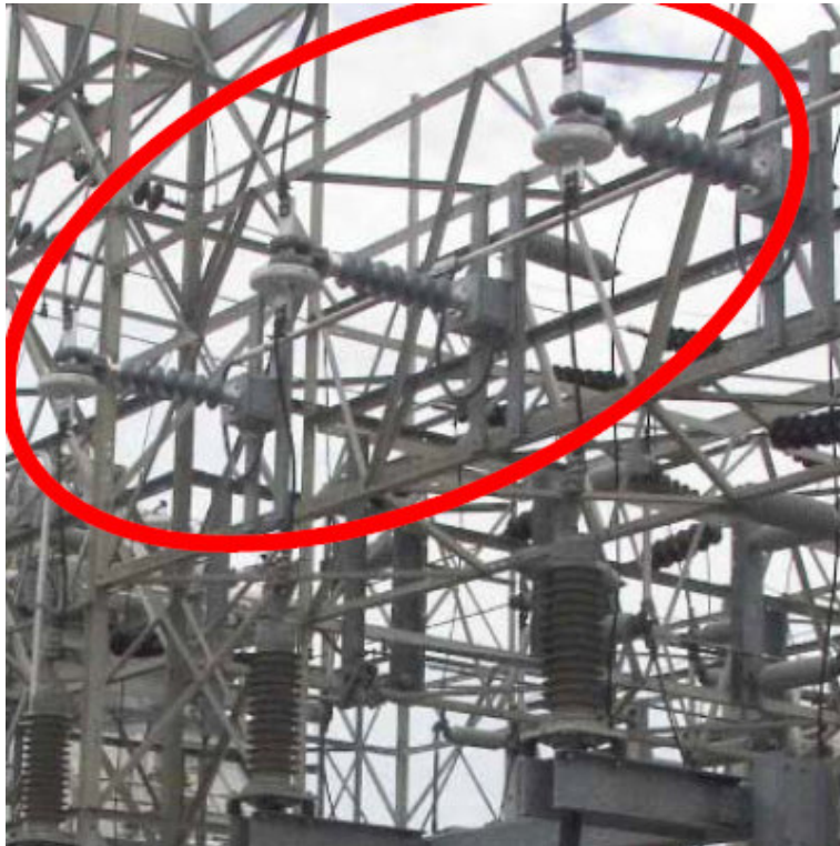
TRANSFORMADORES OPTICOS DE CORRIENTE EN 69KV ESTADOS UNIDOS
