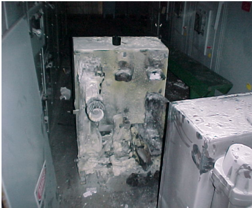
Figura 11. Fotografía del incendio.
