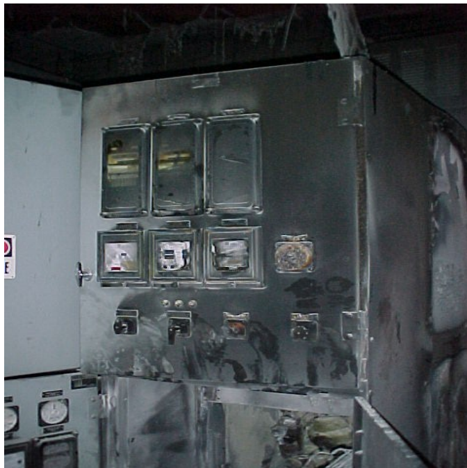
Figura 10. Fotografía del incendio
