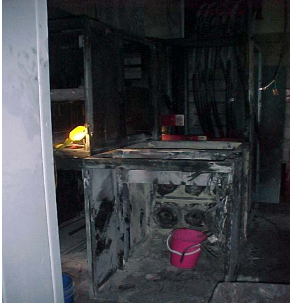
Figura 13. Fotografía del incendio.
