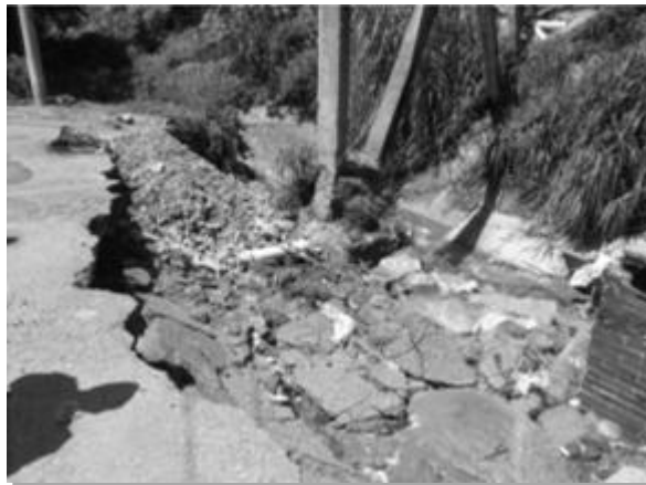
Figura 9. Daños a la estructura asfalto sector 6
