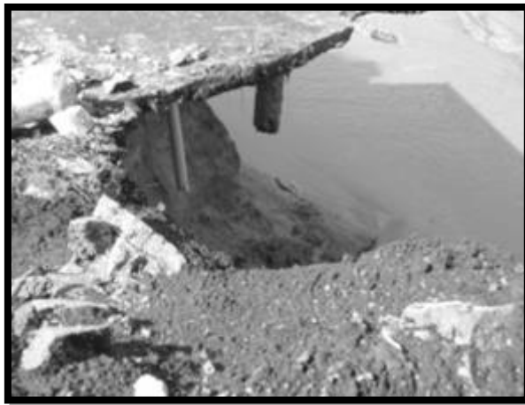
Figura 8. DAÑOS A LA ESTRUCTURA DEL CANAL LATERAL SEC. 2
