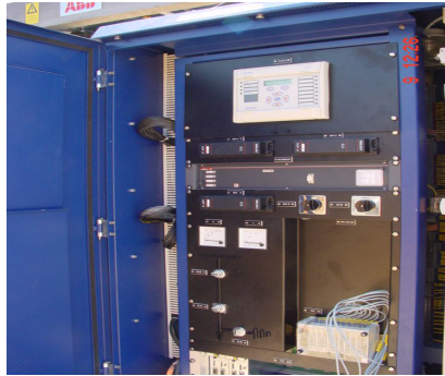
Figura 17: Armario de protecciones de las líneas
