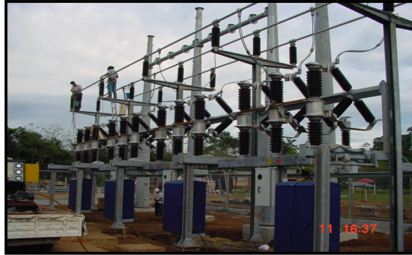
Figura 11. Módulos ABB 69KV
