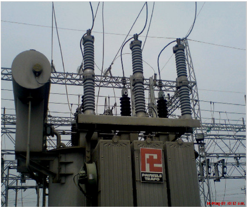
Figura 8. Transformador SSEE Sololá Categoría III
