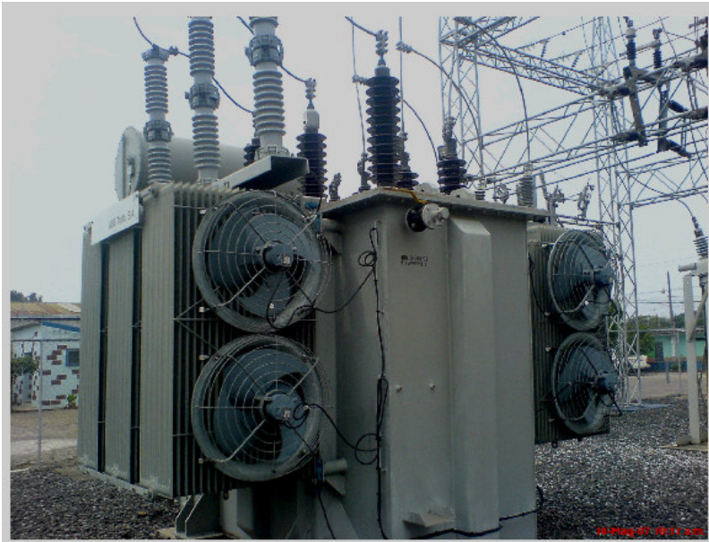
Figura 7. Transformador SSEE Chimaltenango. Categoría III
