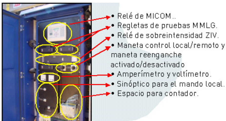
Figura 16. Armario de protecciones, control y mando local
