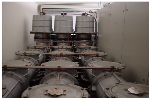
Figura 22. Celdas Siemens 8DA11 de 36 KV
