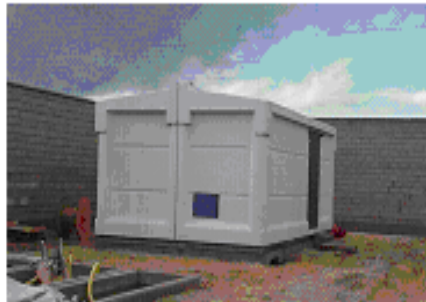
Figura 18. Caseta de media tensión.
