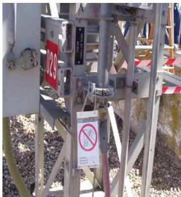
Figura 28: Aplicación de rótulos de “No cierre” en cuchillas seccionadoras de subestación
