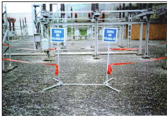
Figura 34: Limitación de áreas de trabajo en subestaciones
