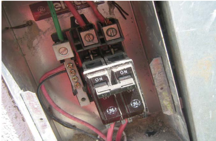
Figura 17. Cable de tierra.
