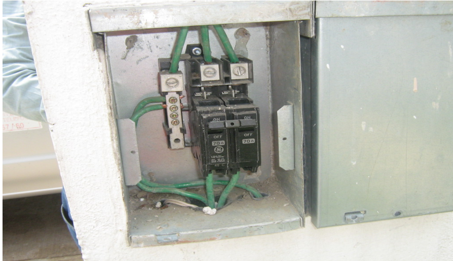
Figura 14. Instalación eléctrica no apropiada.
