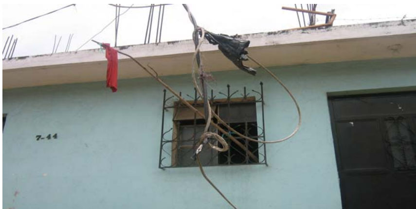
Figura 11. Neutro mal instalado
