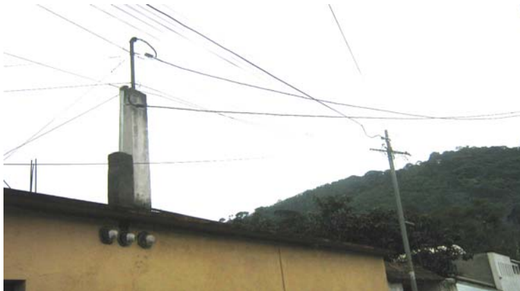
Figura 40. Acoples mal instalados
