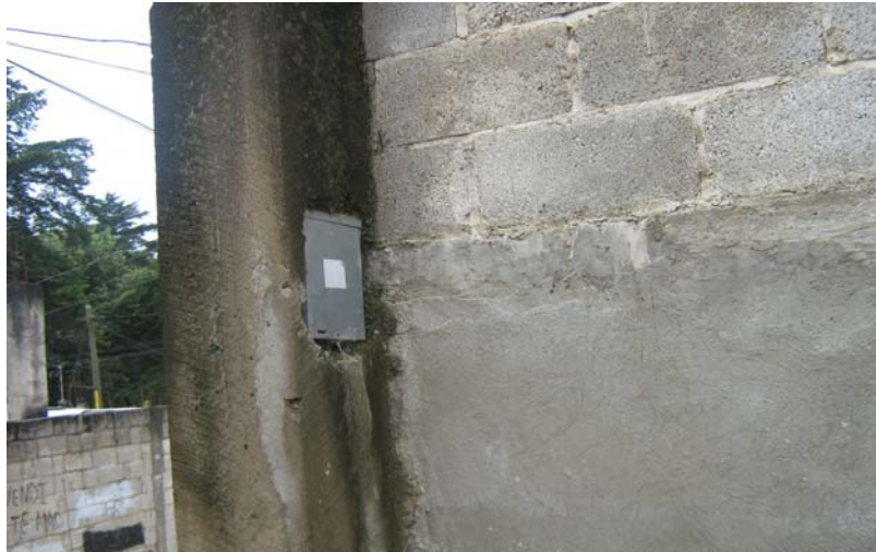
Figura 27. Humedad en caja RH.
