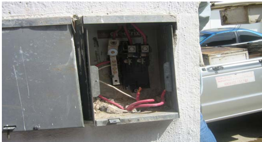
Figura 15. Instalación eléctrica no apropiada.
