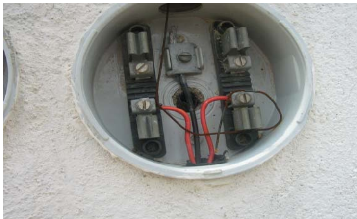
Figura 7. Cable no adecuado.
