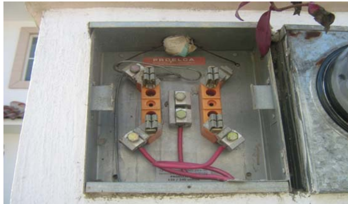
Figura 6. Terminales mal apretadas.
