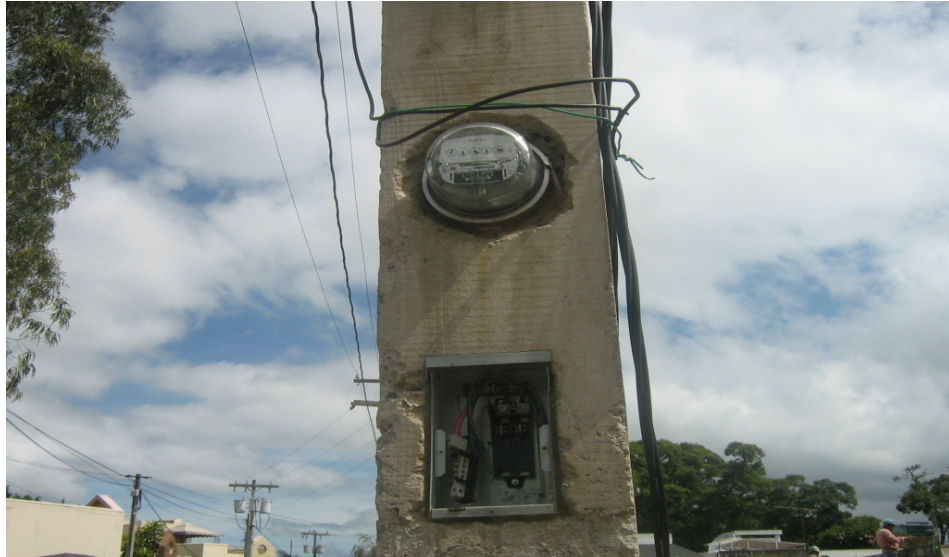
Figura 28. Fallas por humedad.
