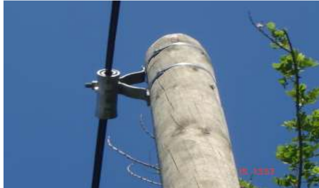
Figura 17. Fibra óptica instalada sobre poste de madera
