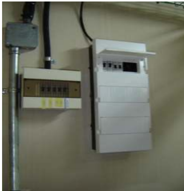
Figura 20. Paneles de distribución de energía AC y DC
