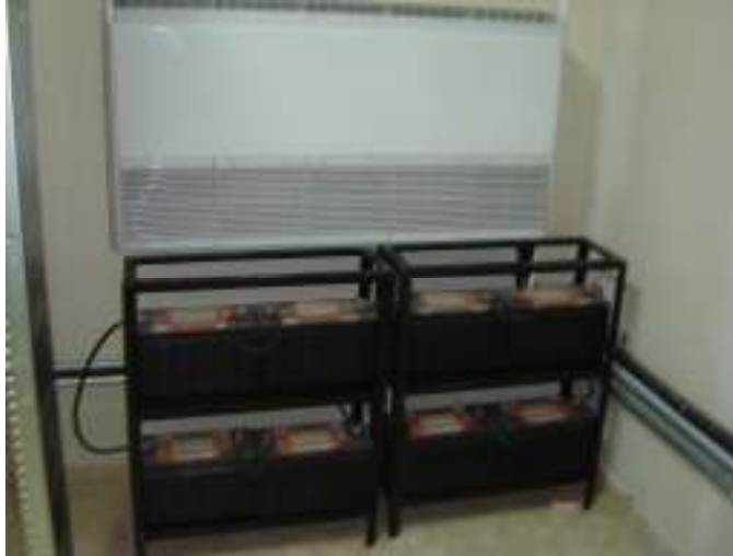
Figura 19. Sistema de climatización y banco de baterías respaldo de energía DC.
