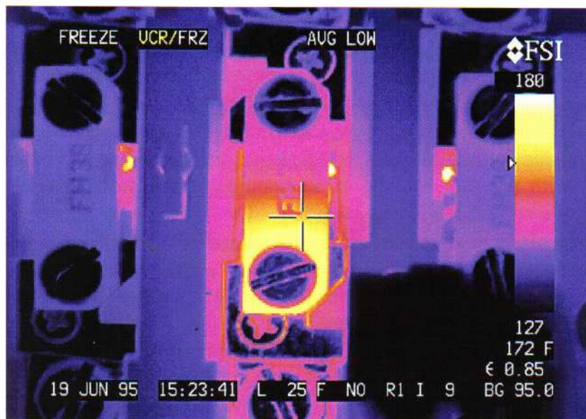
Figura 15. Calentamiento excesivo en una conexión debido a deterioro de la conexión.
