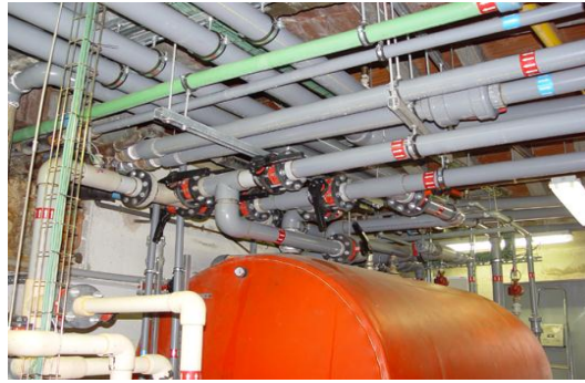
Figura 10. Tuberías para fluidos
