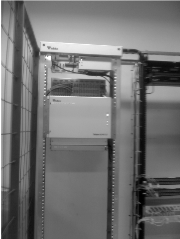
Figura 9. Equipo Tellabs 6340 instalado en POP Proveedor Capacidad Submarina.
