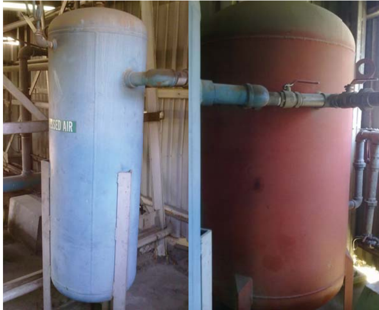
Figura 15. Tanques de almacenamiento
