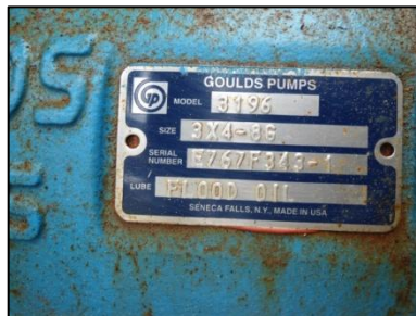
Figura 22. Placa de especificaciones de la bomba II
