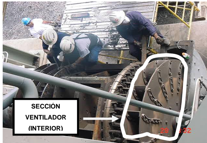
Figura 17. Parte interna sección del ventilador
