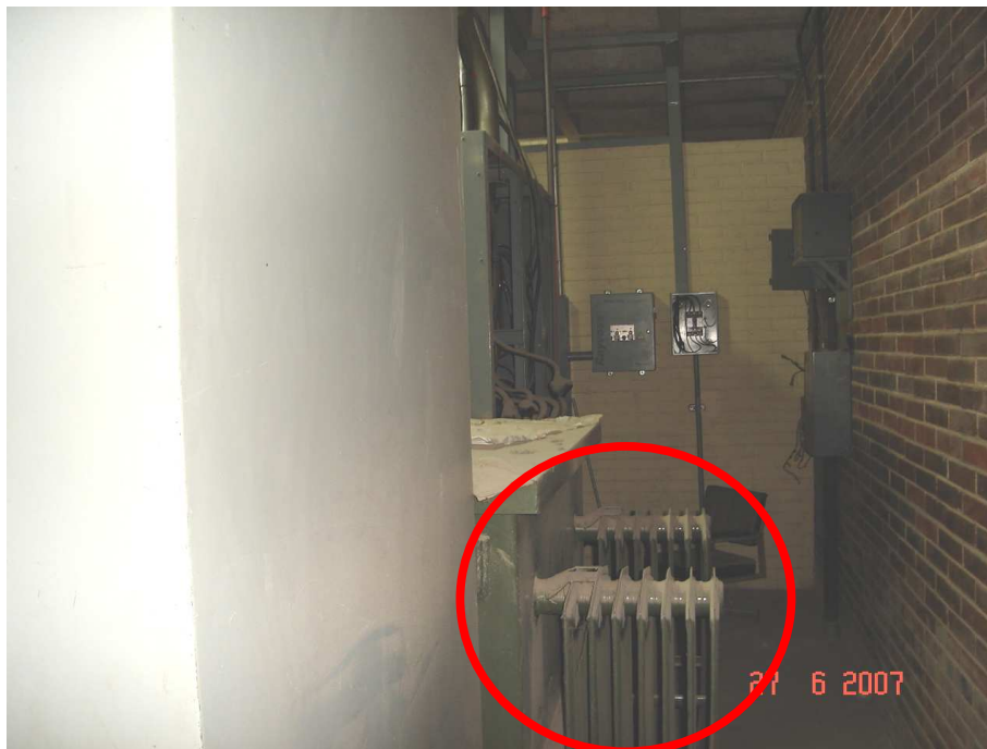
Figura 19. Cuarto del tablero principal del edificio
