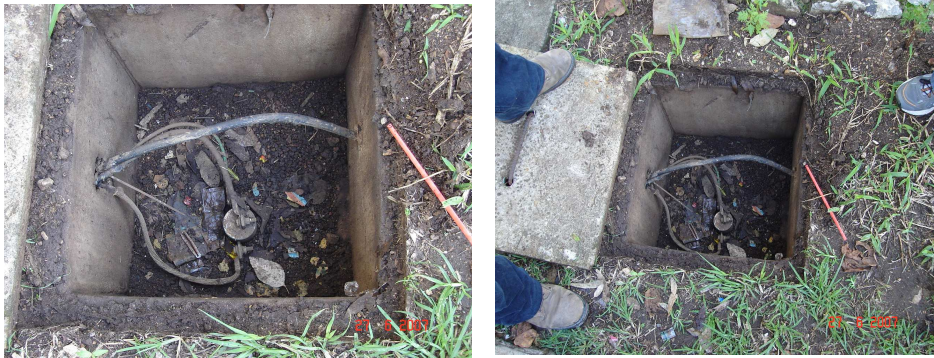
Figura 52. Estado actual de la conexión a tierra del edificio.
