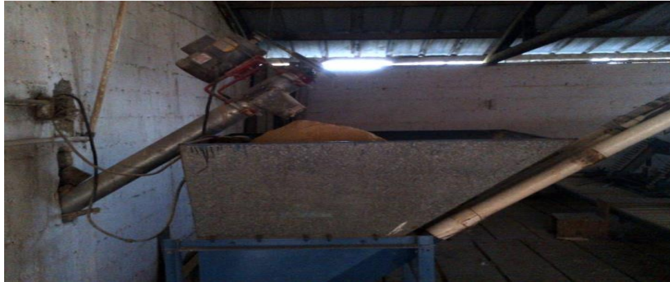
Figura 23. Tolva de entrada de alimentación
