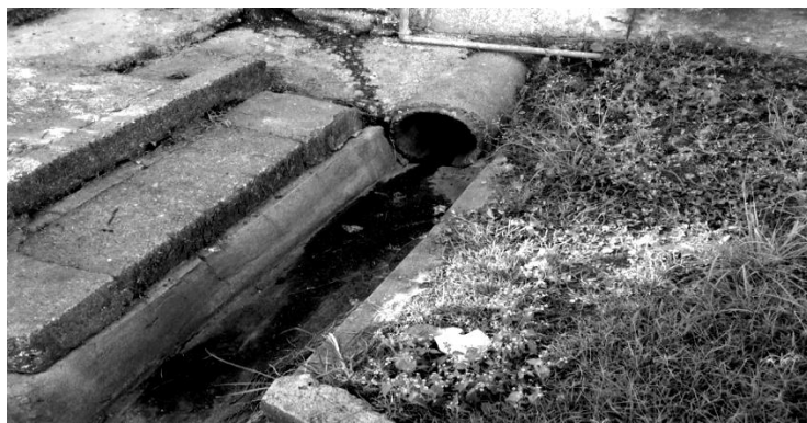
Figura 19. Drenajes sin rejilla de protección
