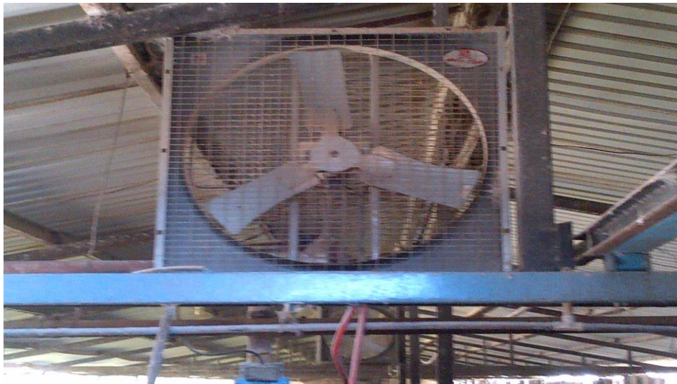
Figura 21. Ventilador aéreo de 3 aspas
