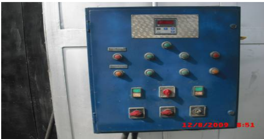
Figura 3. Tablero de control
