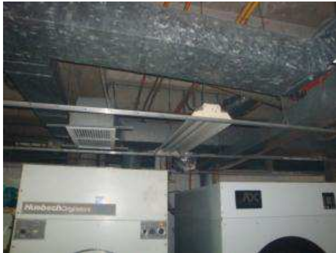
Figura 9. Ductos de ventilación mal ubicados
