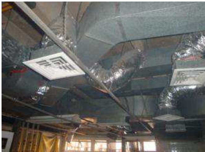
Figura 8. Equipo de ventilación insuficiente
