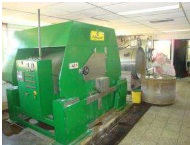
Figura 5. Lavadora de 360 Lb de capacidad
