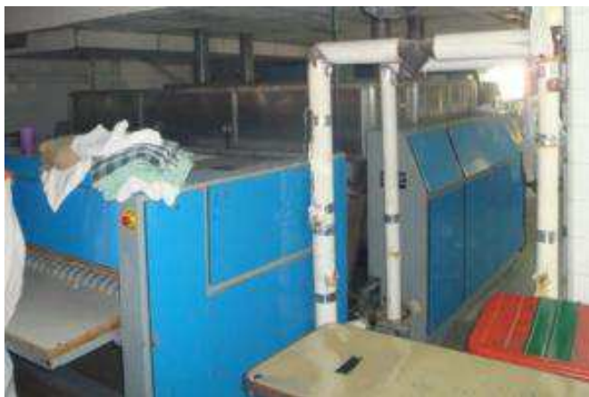
Figura 6. Planchadora de rodillos para sabanas
